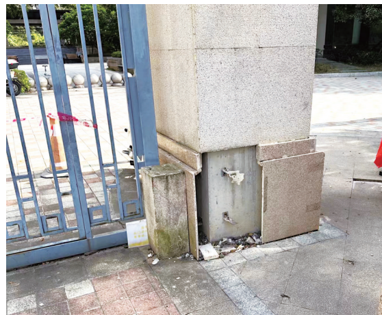
小区北门的门柱下端部分石材脱落
