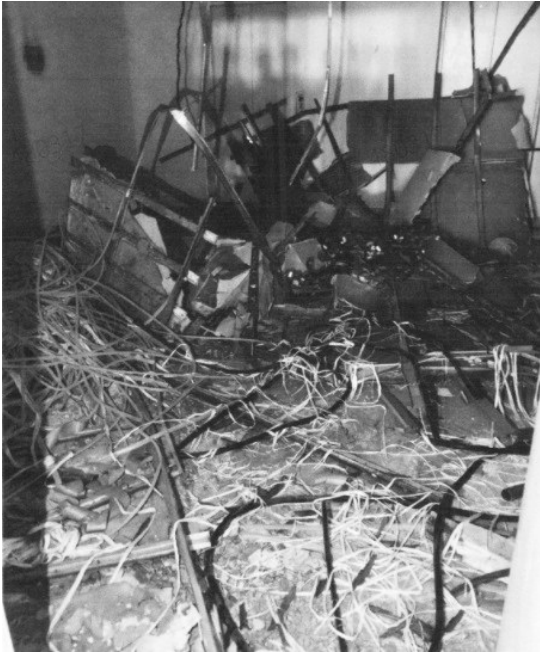
商场内电缆被盗窃 (部门供图)
