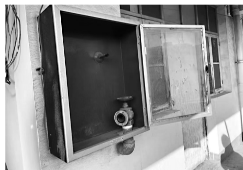
室内消火栓存安全隐患
