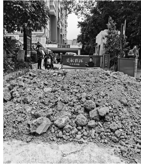
小区门口堆满黄土,车辆无法进出
