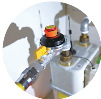
安装好的燃气自闭阀
