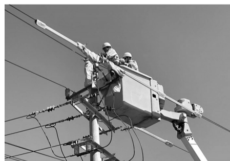
10月29日,亿力集团公司所属福建新源集团不停电作业中心抢修人员正在对20千伏南山山顶支线#4杆固定导线进行抢修消缺
