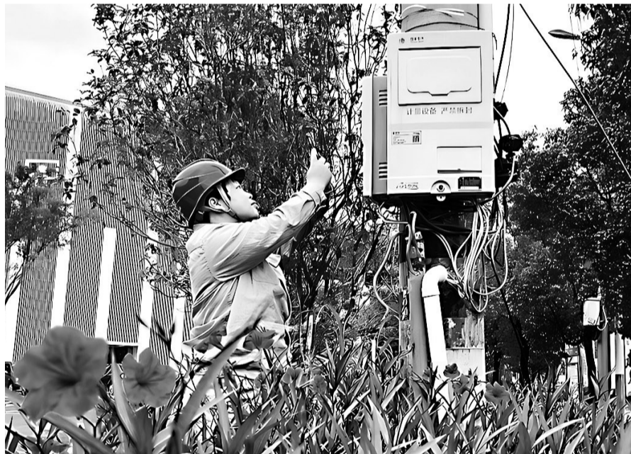
10月31日,亿力集团公司所属福建供电公司龙岩工作部网格人员正在对计量设备运行情况进行记录
