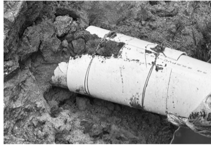
破损的管道外面包了一层切开的新管
