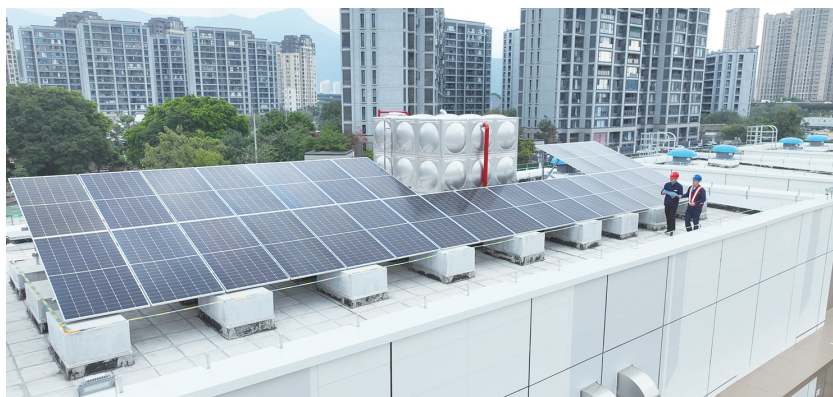
国网福州供电公司工作人员对 110 千伏浦下变电站的设备开展投产前的检查
