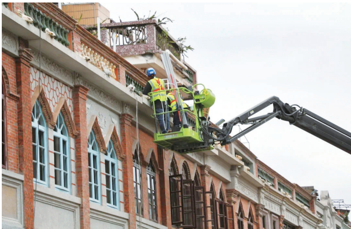
骑楼梁柱置换工程体量大,一天最多完成两根梁柱的置换
