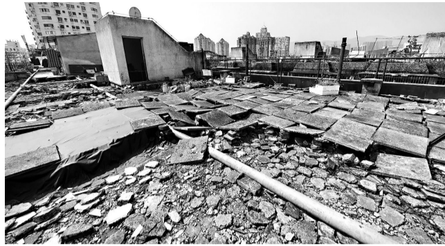
八号楼天台地面破破烂烂
