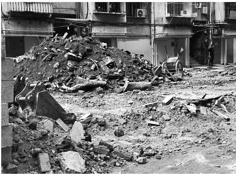
正在改造的楼栋之间,被砍伐的树干随意堆放
