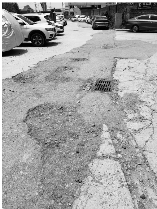
路面坑洼不平,还散落碎裂的沥青块和石子
