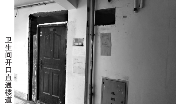
卫生间开口直通楼道
