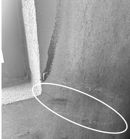
林先生的房屋已出现裂缝(画圈处)
