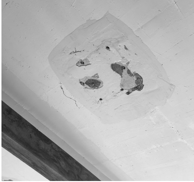
林先生的房屋已出现裂缝(画圈处)后,物业采用「打针」方式修补
