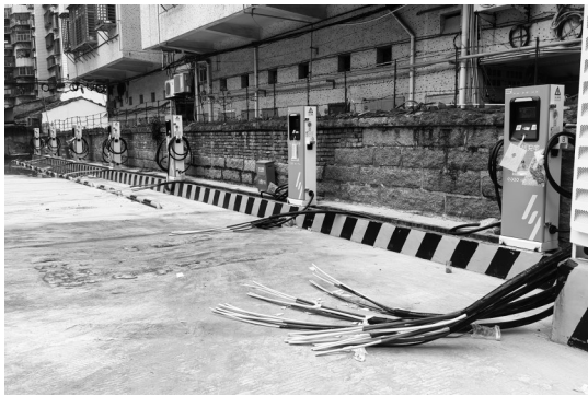
5日下午,记者看到居民楼下已经安装的部分充电桩
