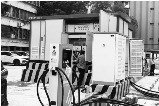
停车场还装了两台变电器
