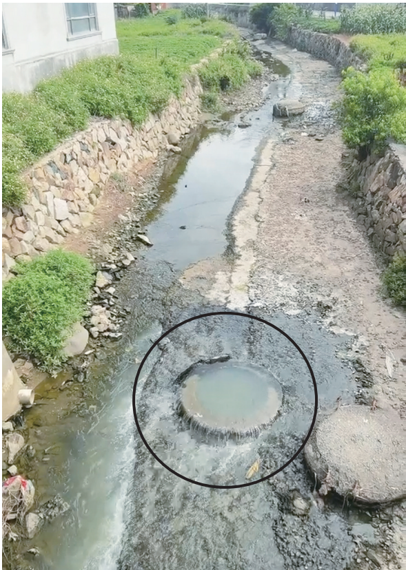
污水从污水井中溢出
