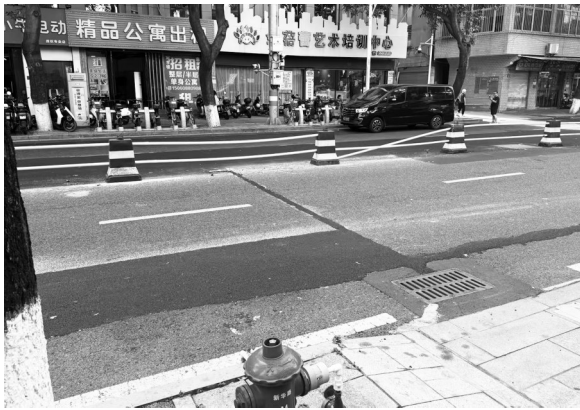
新华南路开裂沉降处已应急灌注沥青
