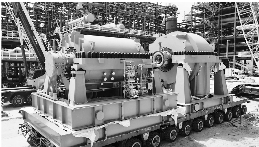
裂解气压缩机组(陈汉祥/摄)
