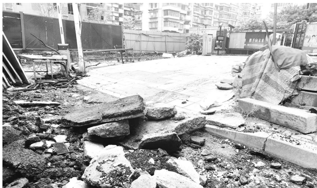
建筑垃圾堆在车库出入口
