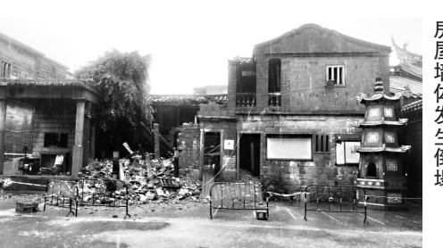
房屋墙体发生倒塌,设置好警戒线不久,
