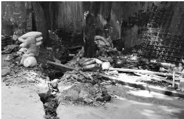
小区后门道路被开挖
