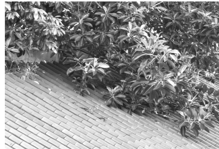
屋顶瓦片也有滑落隐患
