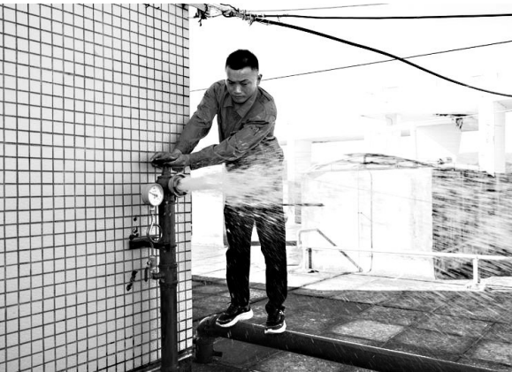
小区的消防管道通上消防水了
