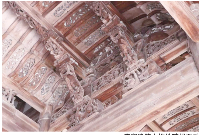
庄寨建筑木构件破损严重
