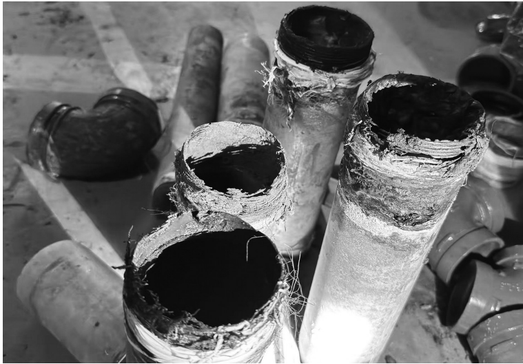
拆卸下的旧管道部件被集中堆放,腐蚀严重
