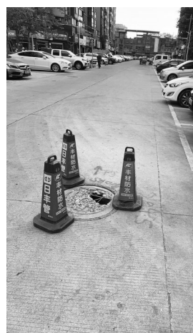
道路中间井盖破损
