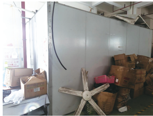
整改前,公司使用易燃材料做隔墙
