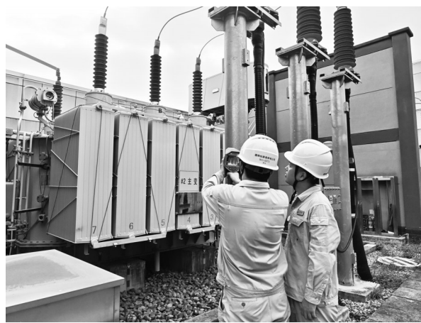
运维人员巡检供电设备
