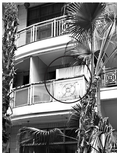
阳台被隔断,搭建简易卫生间(画圈处)
